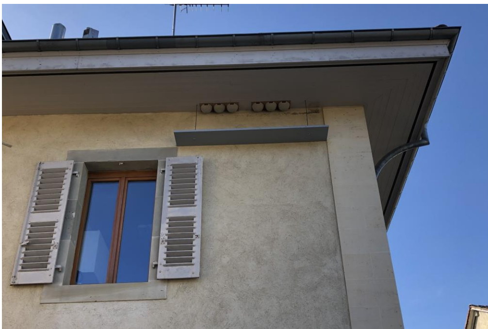
Photo 3 (Gy) : Sur l'école primaire, 6 nids et une planchette anti-salissures ont été installés car des traces d'anciens nids ont été constatées (à droite des nids artificiels).
