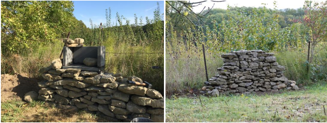
Figures 5 et 6 : Deuxième chantier dans la région de Cartigny. À gauche, la construction du mur et à droite, le mur terminé avec la cavité artificielle.
